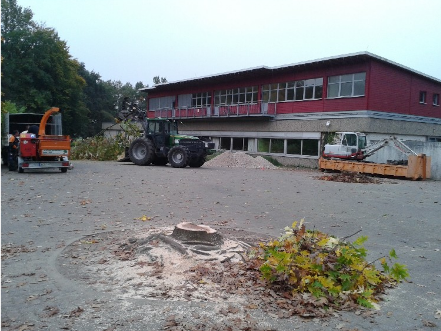
In den nächsten beiden Jahren prägen Baumaschinen die Szene auf dem Schulhof der Hessenwaldschule. Foto Roland Lörzer
